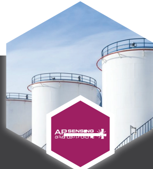
Yüzer Çatılı Tanklar
